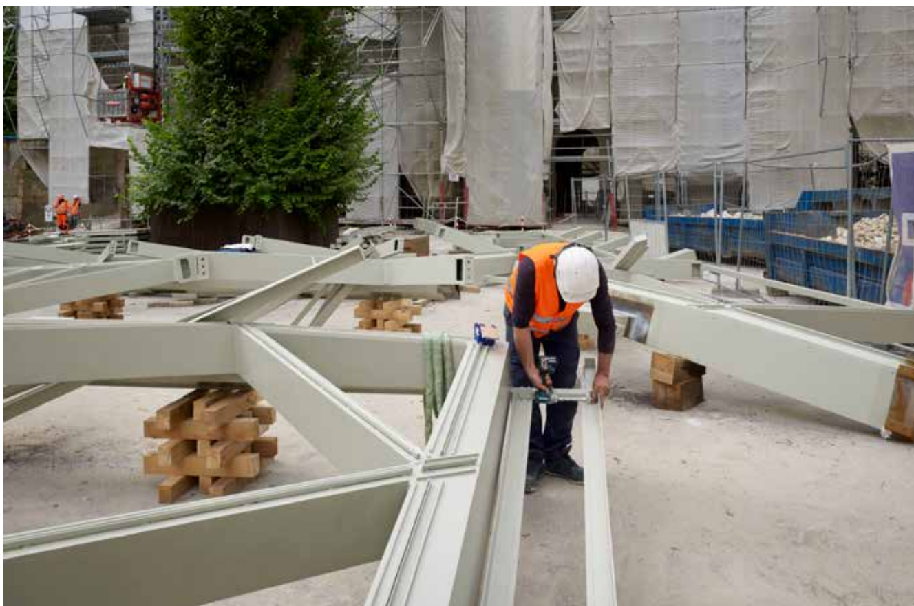
Assemblage de la structure métallique de la future verrière © Pierre-Olivier Deschamps / Agence Vu' – CMN
