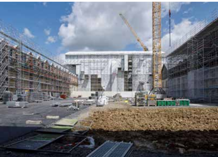
Château de Villers-Cotterêts, cours des offices en travaux © Pierre-Olivier Deschamps / Agence Vu' - CMN
